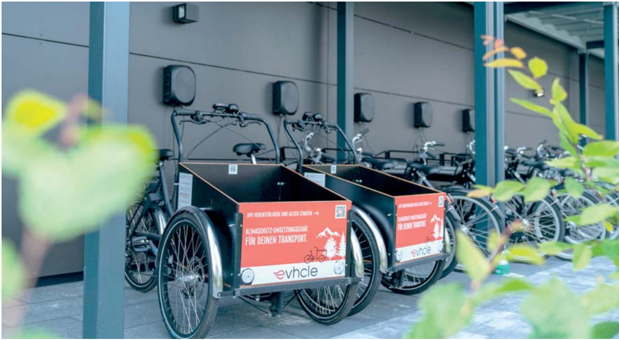
Bild 1: Ladestation für E-Bikes und Lastenräder. © NXTBAU GmbH
